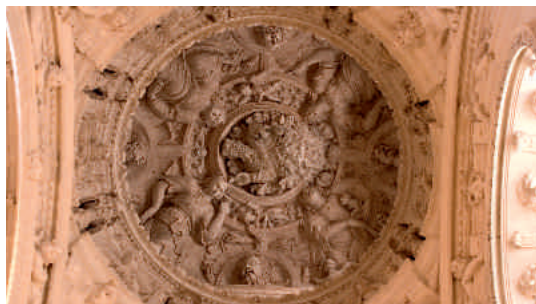
Iglesia de Santa María de Albarracín. Cúpula de la estancia anexa a la capilla
